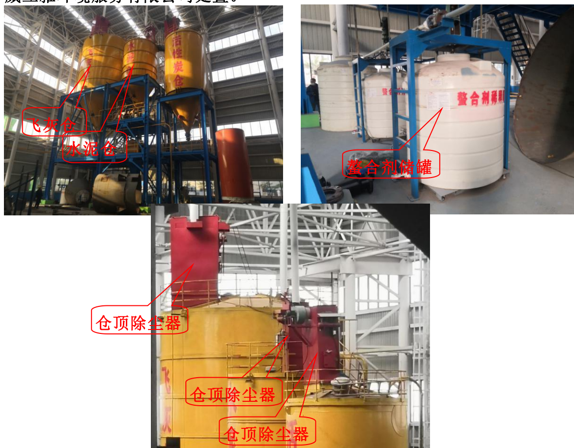
图 3-13 除灰渣系统相关设备设施概貌
