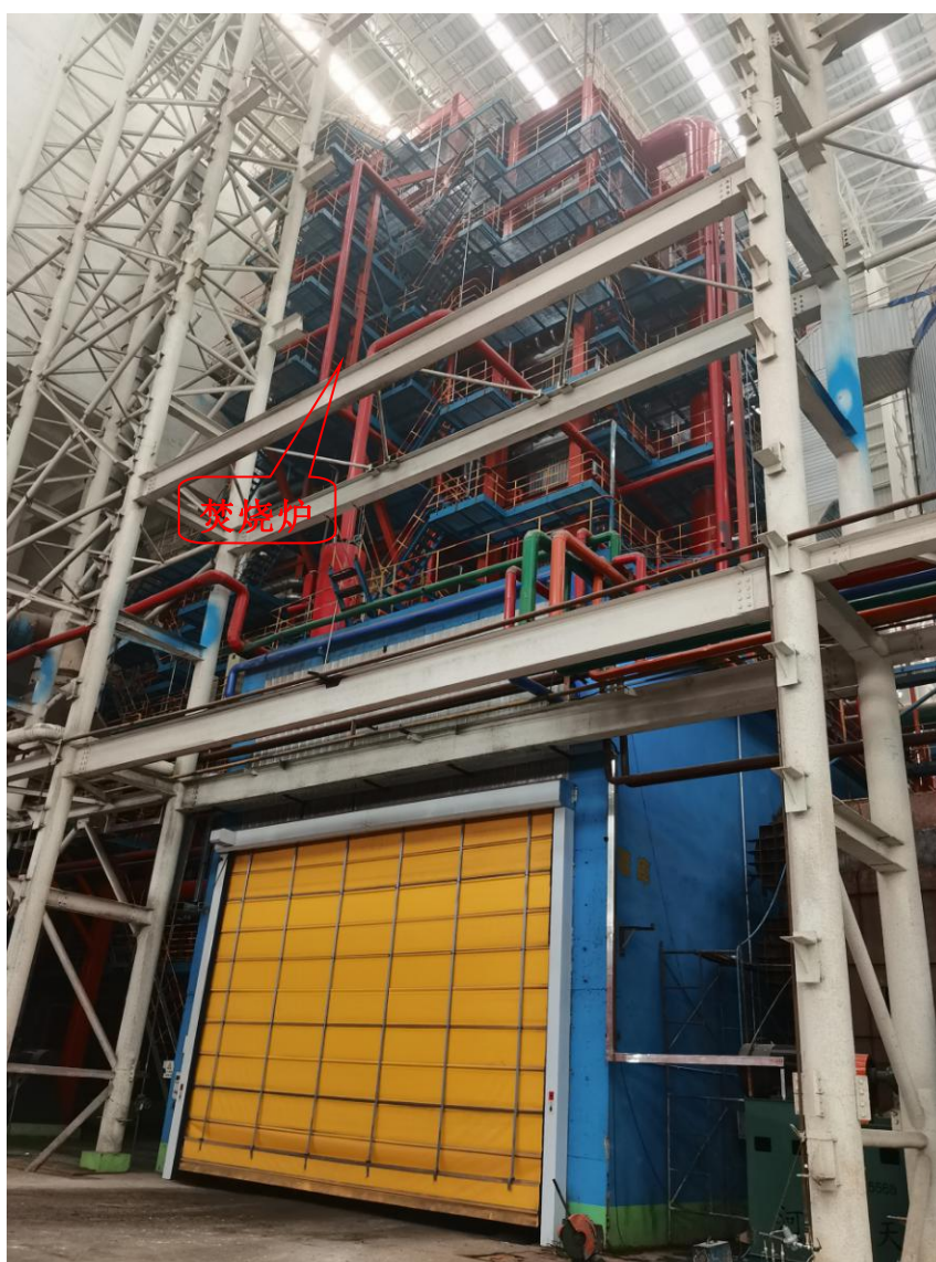
图 3-5 垃圾焚烧系统设备设施概貌
