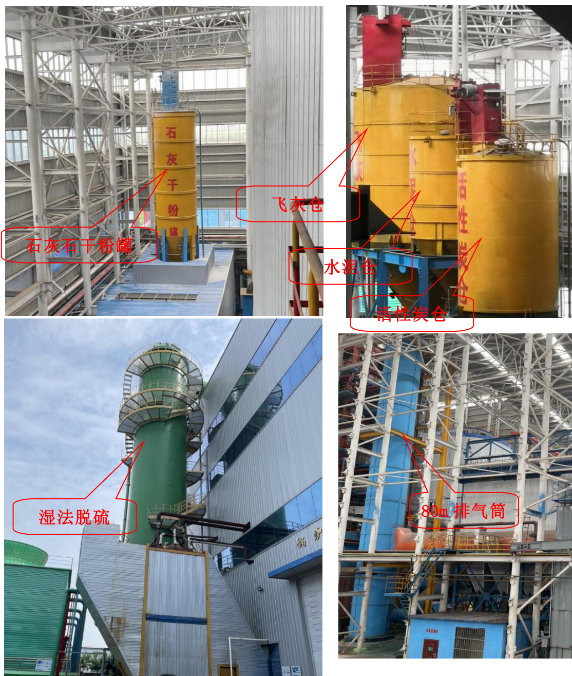
图 3-9 烟气净化系统相关设备设施概貌
